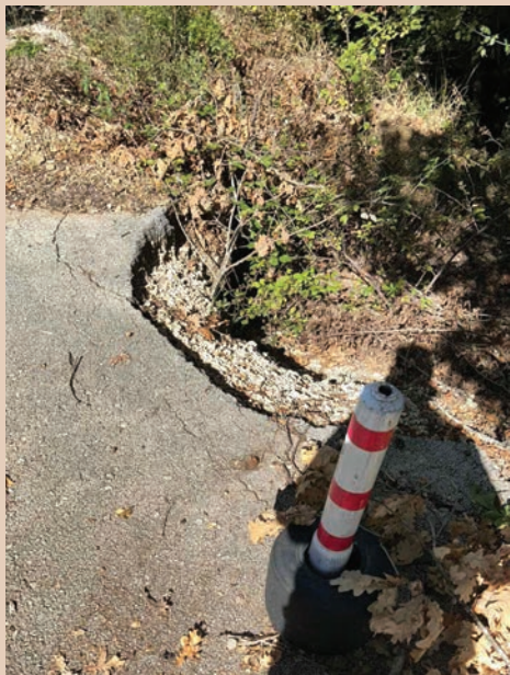
Καθίζηση -τομή οδοστρώματος στη σύνδεση του δικτύου με το Πιεστικό συγκρότημα
