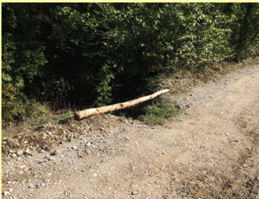
2 η αποκατάσταση: Η κατάπτωση στα Αναστασοπουλείικα
