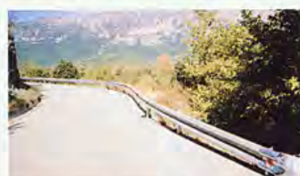
Στηθαία ασφαλείας στη στροφή Κρυονερίου προς γέφυρα Τζαρή!
