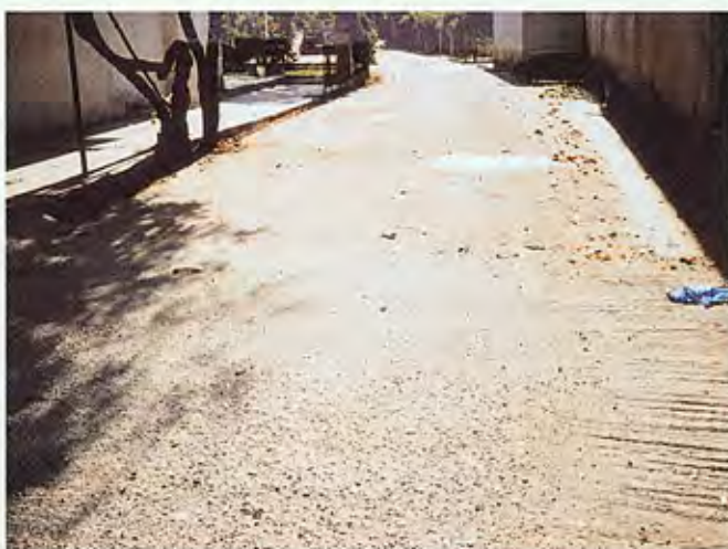
Ο δρόμος από οικία ΚΑΖΑΚΟΥ προς ΑΓΙΑ ΑΙΚΑΤΕΡΙΝΗ... «Ξέφτισε» ένα χρόνο μετά την κατασκευή του. Ακατάλληλο υλικό από το ποτάμι; Λίγο τσιμέντο; Ας το κρίνουν οι ΑΡΧΕΣ!
